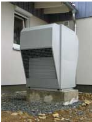
Außen aufgestellte Luft-Wasser Wärmepumpe LWP 11 A von Uponor. Im Gebäude befindet sich lediglich die Außentemperatur gesteuerte Wärmepumpenregelung sowie der Pufferspeicher und die Warmwasseraufbereitung.
